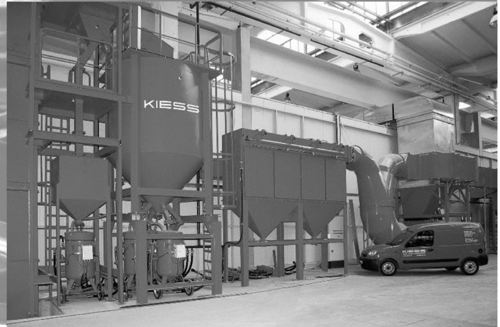
Anlagentechnik einer stationären Großstrahlhalle
