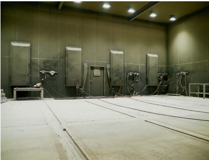
Strahlhalle aus stabiler Stahlrahmenkonstruktion: die Rückwand der Halle mit Kabeldurchführung und Absaugwände der Filteranlage.
