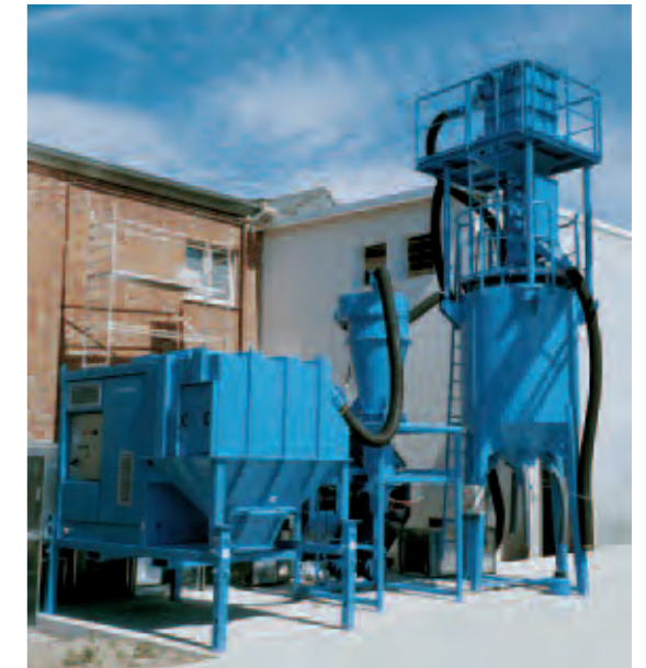
Sauganlage mit Reiniger, Magnetabscheider, Vakuumsilo und Zyklonabscheider
